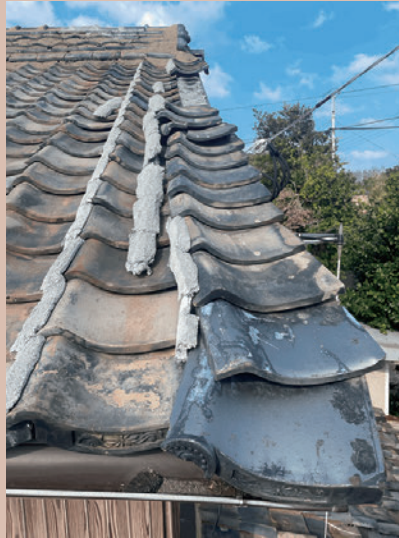
去年の台風の際にシャワーのような雨漏りが発生しました、
