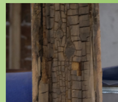
壁側柱の多くは腐食している
