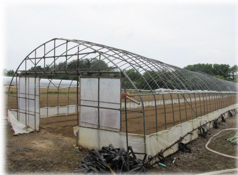
長寿命化対策が必要な老朽化した園芸ハウス
